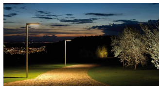
ILUMINAÇÃO GERAL – Luminária poste KUBE N2
